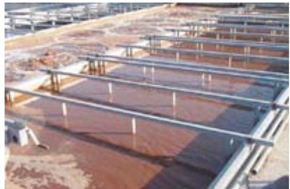
Figura 4.13. Detalle reactor aeróbico (izquierda) y reactor anóxico (derecha)
