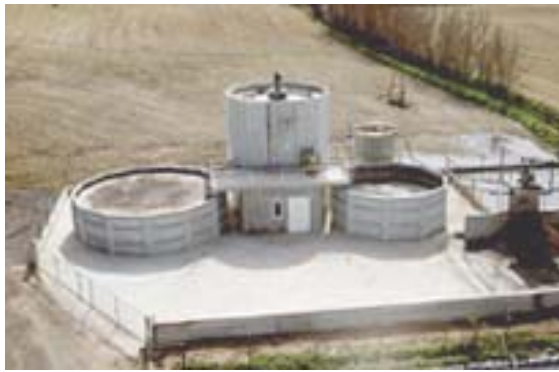
Fig. 4.12. Instalación de Nitrificación - Desnitrificación
