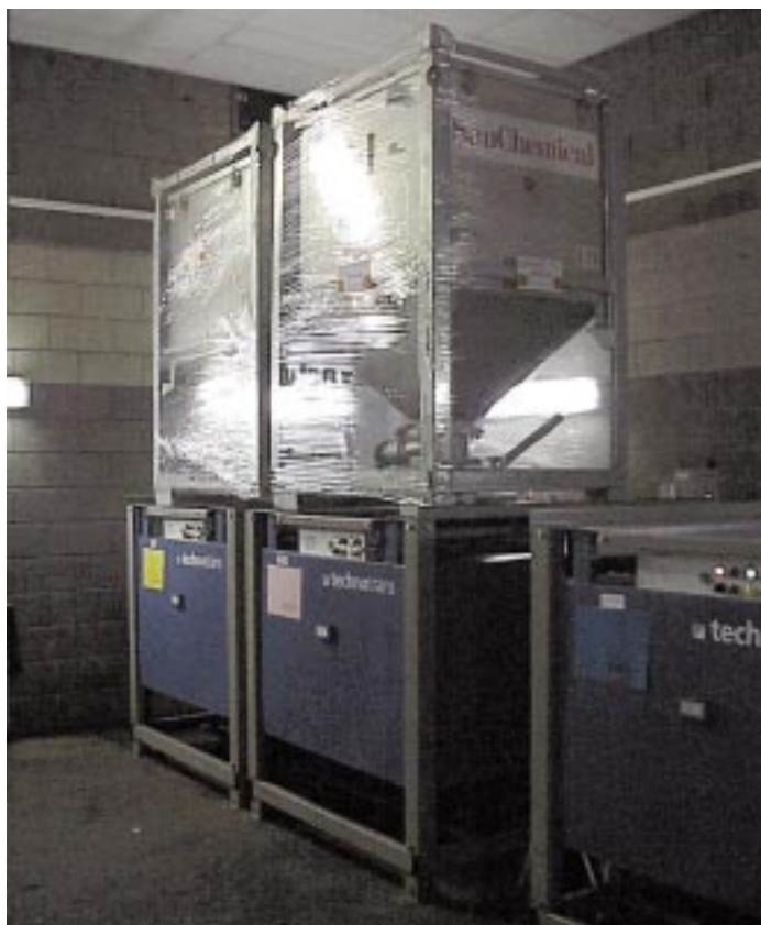
Part del nou sistema d'emmagatzematge i dosificació de tintes
